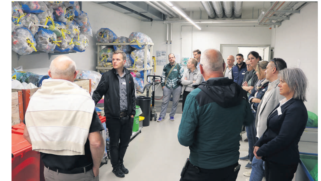
Beim Rundgang durch die unterirdischen Räume wurden spannende Einblicke gegeben. Hier der Recycling-Raum.
